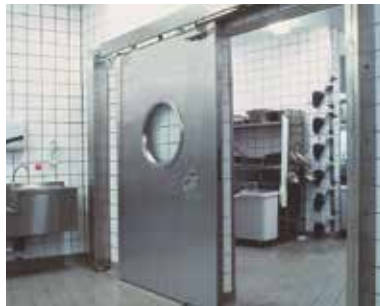
Feuerschutz-Schiebetor in einer Großküche.
