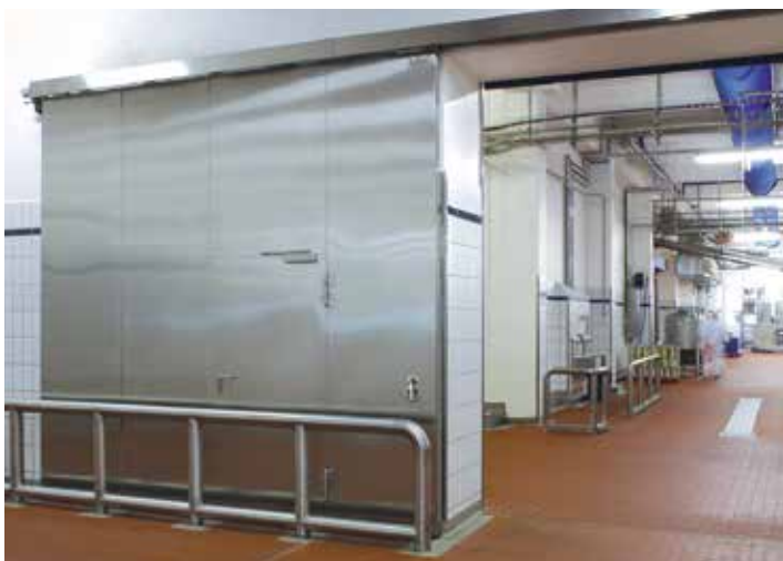
T30 Feuerschutz-Schiebetor, mit Schlupftür, in der Lebensmittelproduktion.
